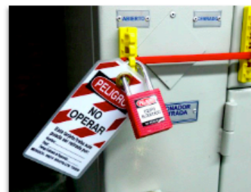
Imagen 6. Seccionadores permanentemente bloqueados
