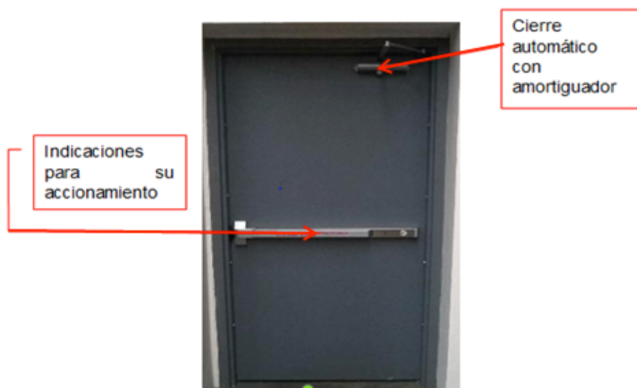
Figura V - 18. Ejemplo de puerta de emergencia
