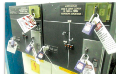
Imagen 8. Transferencias automáticas permanentemente bloqueadas
