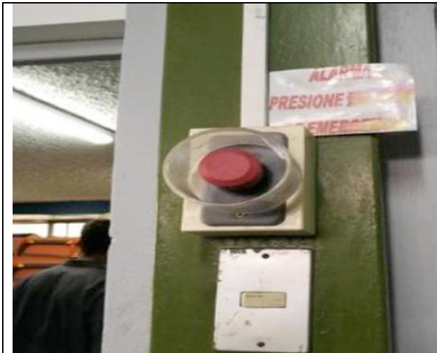
Figura ix -33. Botonera de emergencia sin rotular en el 1º nivel del CIEMTEC
