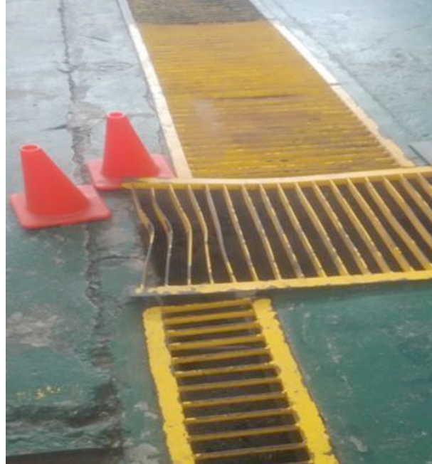
Figura IX - 36. Rejillas dañadas en el 1º del CIEMTEC
