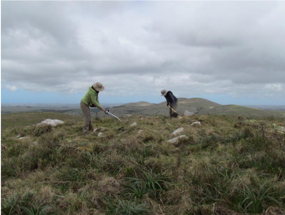
Figura 127: Desmalezado de vegetación que cubría la estructura MCH durante la primera intervención (ITMCH01) en el año 2013. Viste desde NE. Fotografía: Archivo LAPPU.
