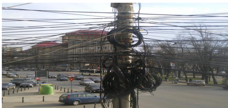
Fig. 1. 13. Imagen cables fibra óptica en Rumanía
