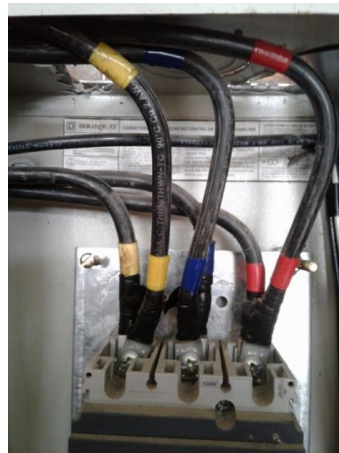
Figura 2.21. Conexión de la RED UTP con el sistema solar fotovoltaico.
