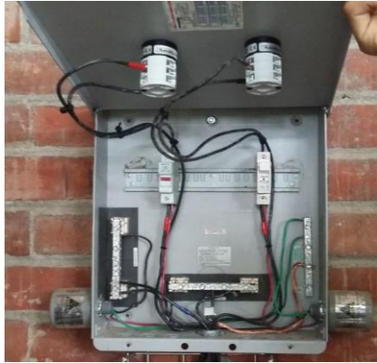
Figura 2.6. Tablero de corte y protección entradas MPPT.
