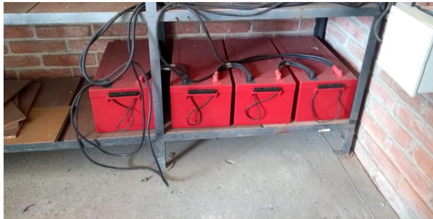
Figura 2.4. Banco de acumuladores.
