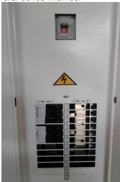
Figura 2.19. Tablero de transferencia de energía solar fotovoltaica a la RED
