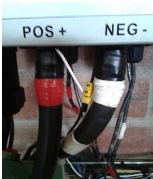
Figura 2.11. Conexión entrada de acumuladores GEINFINI SOLAR
