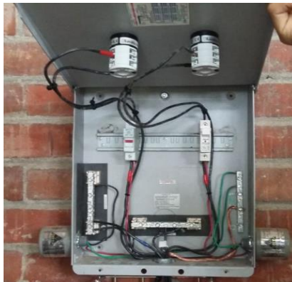
Figura 2.15. Tablero de corte y protección entradas MPPT
