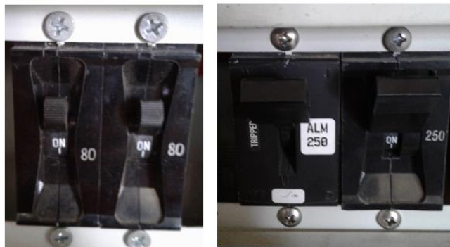
Figura 2.5. Protecciones DC banco de acumuladores.
