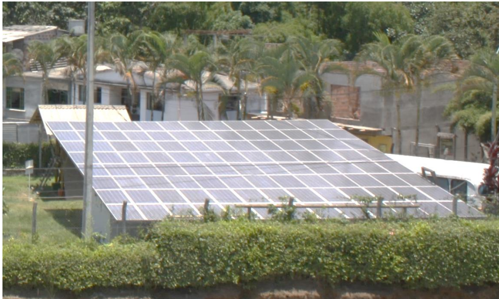
Figura 2.1. Sistema fotovoltaico implementado
