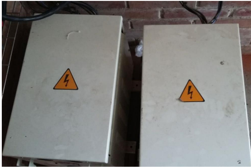
Figura 2.12. Transformadores de aislamiento 12 kVA 440 V/208 V trifásico
