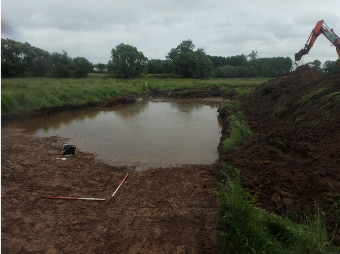
Figuur 24: Wateroverlast bij de aanleg van werkput 37.
