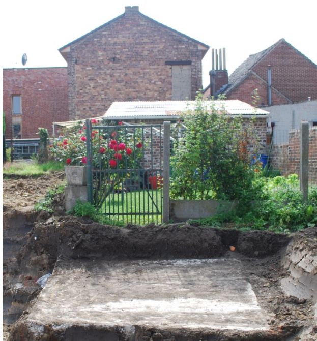
Afb. 20. De betonplaat die op de helling lag, waarover het smalspoor naar het fabrieksgebouw leidde. De deur rechts in het gebouw is nu met betonstenen dichtgezet.
