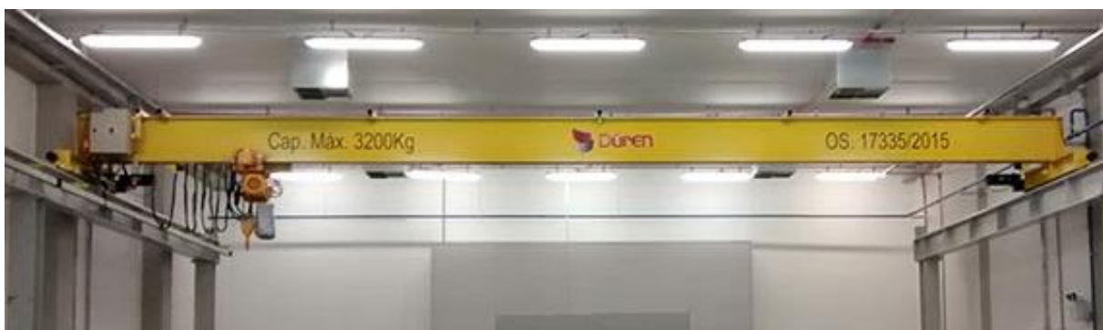
Figura 02 - Ponte Rolante Univiga
