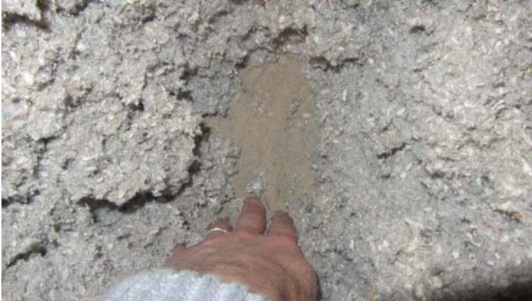
Kuva 20. Ullakkotilan yläpohjan lisälämmöneristeenä on selluvilla, jonka alapuolella on alkuperäinen hiekka- ja olkieristekerros.
