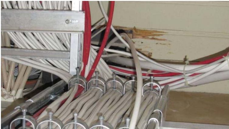
Kuva 2. Ensimmäisen kerroksen sähkökaapissa on tiivistämättömiä välipohjan läpivientejä.
