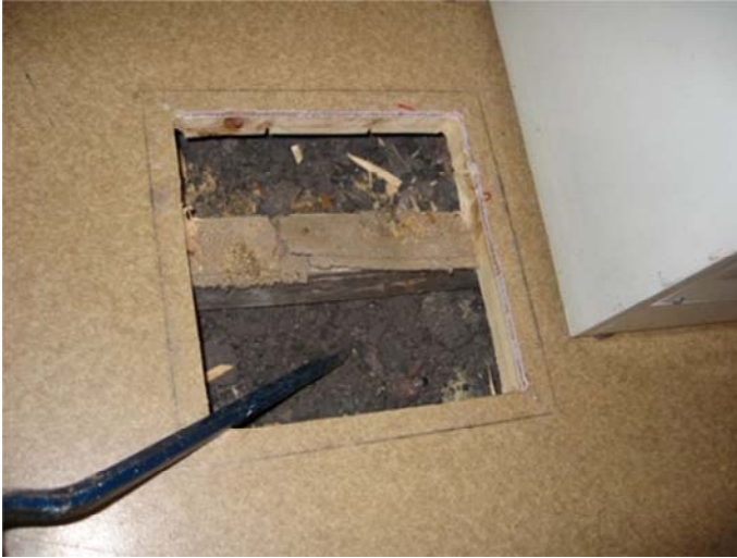
Kuva 16. Luokkatilojen välipohjien ontelotilassa on täyteaineena koksikuona ja kiviaineista rakennusjätettä. Kuva on otettu korjausvaiheessa.
