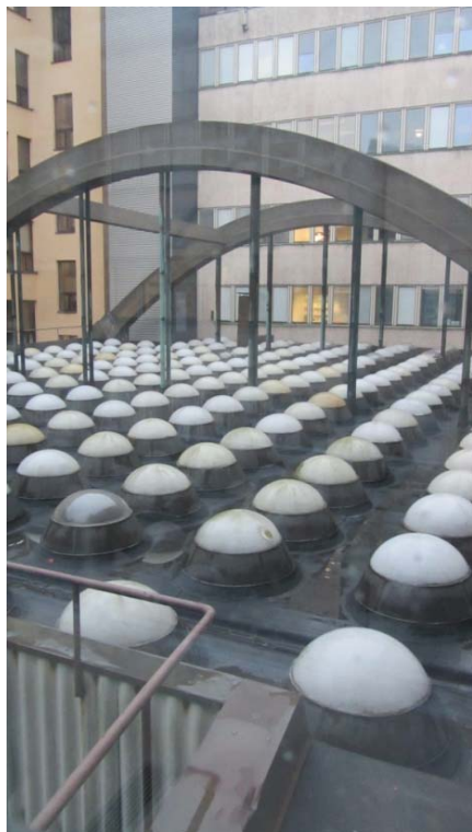
Kuva 29. Luentosalin vesikatteissa on useita kupoli-ikkunoita ja vesikatteella on lammikoitunutta vettä.
