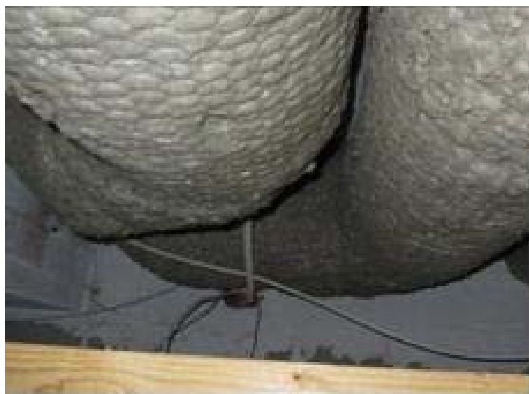
Kuva 11. Käytävän alakatossa on pinnoittamatonta mineraalivillaa.
