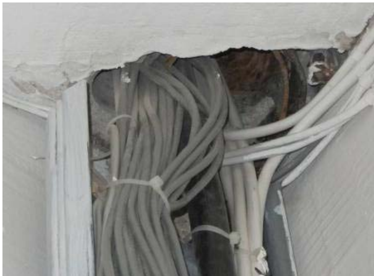
Kuva 24. Ensimmäisen kerroksen huoneen vaatekomerossa on tiivistämättömiä läpivientejä yläpohjarakenteen kautta seuraavaan kerrokseen.
