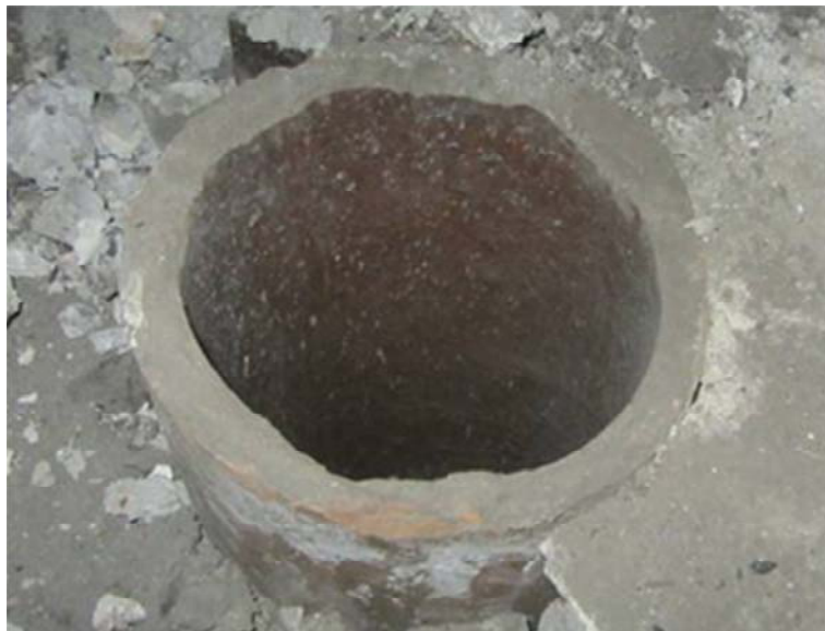
Kuva 22. käytöstä poistettu viemärin tuuletushormi, joka on jätetty auki yläpohjan ullakotilaan.
