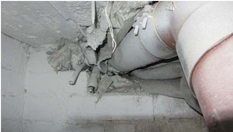
Kuva 33. Kellarin maanvastaisessa seinärakenteessa on tiivistämättömiä talotekniikan läpivientejä.
