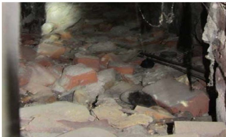
Kuva 4. Yhden työhuoneen kantavan alapohjan ryömintätilassa on rakennusjätettä.
