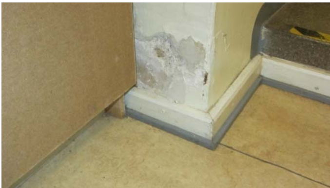
Kuva 17. Ensimmäisen kerroksen maanvastaisissa seinärakenteissa on näkyviä maaperäkosteuden aiheuttamia maali- ja tasoitekerroksen vaurioita.
