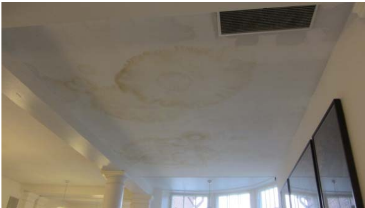
Kuva 13. Kolmannen kerroksen sisäkattopinnassa on näkyviä vesivuotojälkiä, jotka aiheutuvat vesikaton vaurioista ja katon rakenteiden epätiiviyyskohdista.
