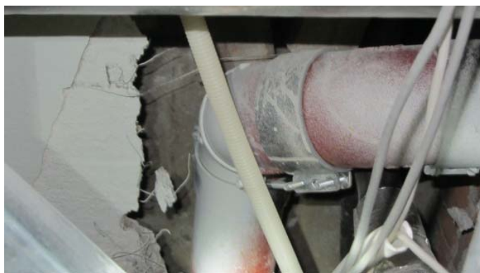
Kuva 26. Ensimmäisen kerroksen sähköjakokaapin ja viemäriputken läpivientä ei ole tiivistetty.
