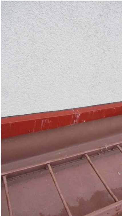
Kuva 32. Seinä- ja kattorakenteen liitoskohdassa on ollut vesikatevuoto, joka on korjattu.
