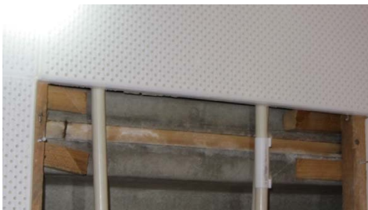
Kuva 34. Välipohjarakenteen (ripalaattaelementti) elementtien liitossaumassa on rakennusaikainen valulauta.
