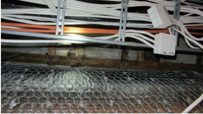
Kuva 31. B-osan vesikatteessa on ollut paikallinen vuotokohta. Yläpohjarakenteen sisäpinnassa on rapattu lastuvillalevyeristys ilman höyrynsulkuja.
