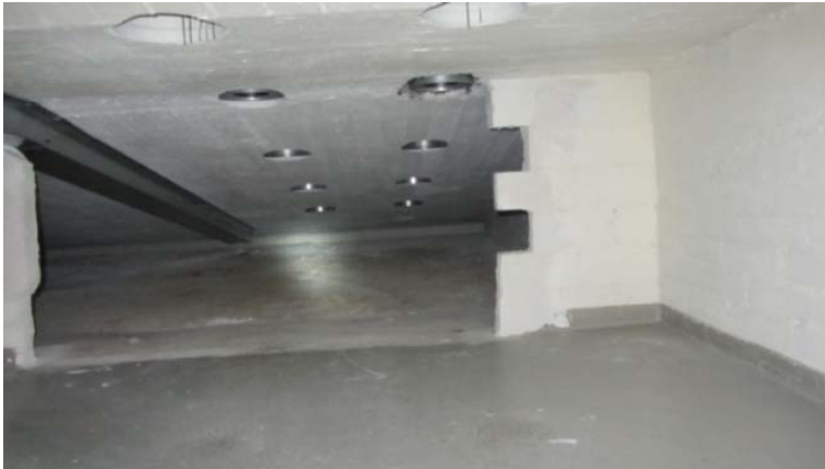
Kuva 35. Suuren luentosalin tuloilma saadaan lattiarakenteen alapuolella olevasta ilmanjakuhuoneesta. Huoneen lattiapinta on osittain pinnoittamatonta betonilattiaa.
