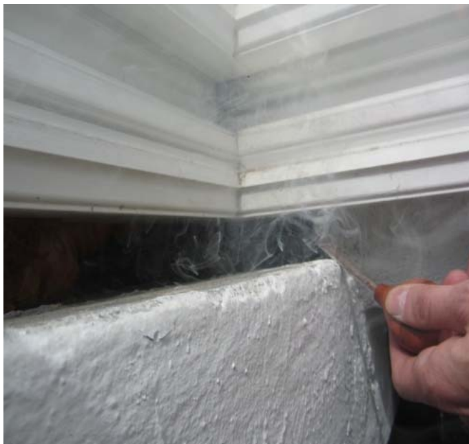
Kuva 36. Ulkoseinän ja ikkunan rakenneliitos on tiivistämätön. Ilmavirtausten liikettä havainnollistettiin merkisavujen avulla.
