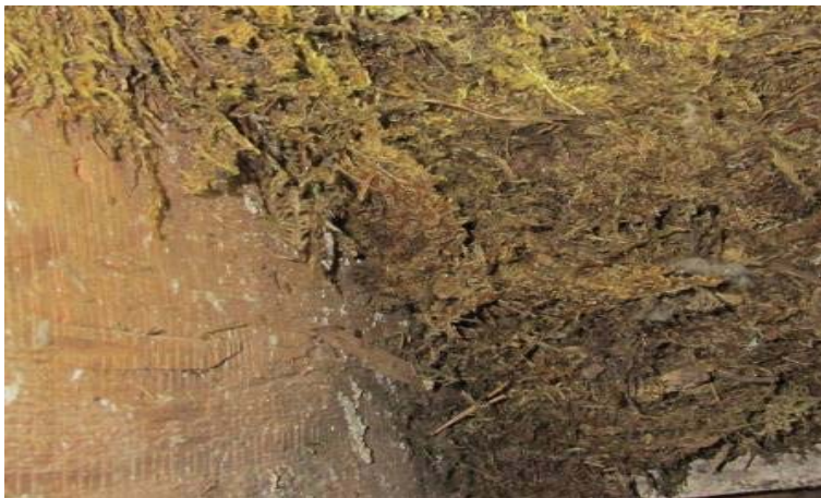
Kuva 3. Työhuoneen kantavan alapohjarakenteen lämmöneristeenä on sammalta.
