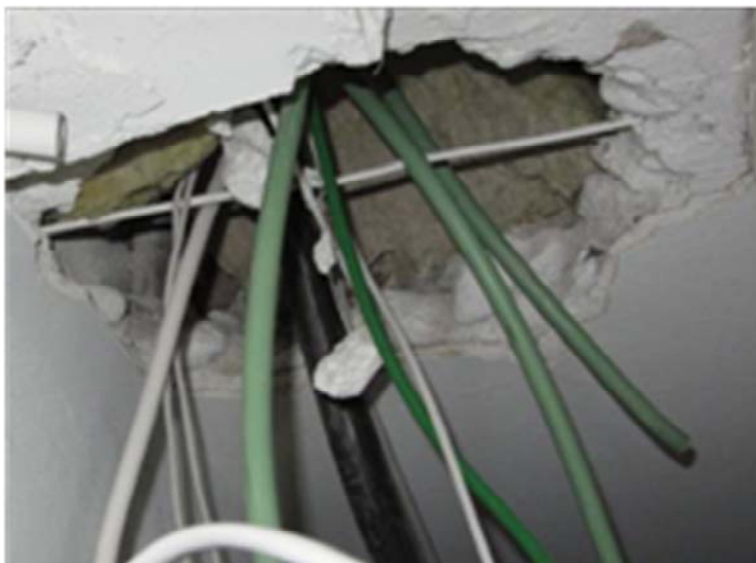
Kuva 10. Käytävän alakaton teknisessä tilassa on tiivistämättömiä välipohjan läpivientejä.
