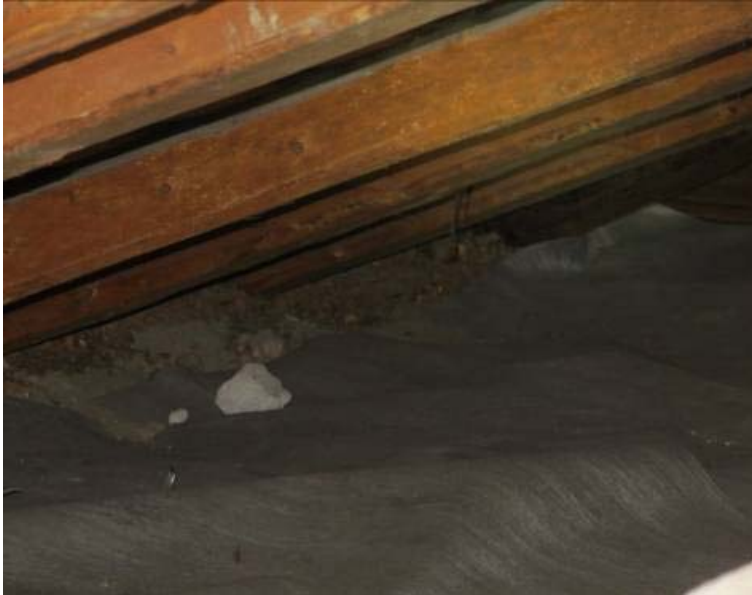
Kuva 9. Kutterilastu- ja sahanpurueristys on lapeosien kohdalla kiinni vesikatteessa. Yläpohja ei tuuletu räystäsrakenteiden kautta. Peltivesikatteessa ei ole aluskatetta.
