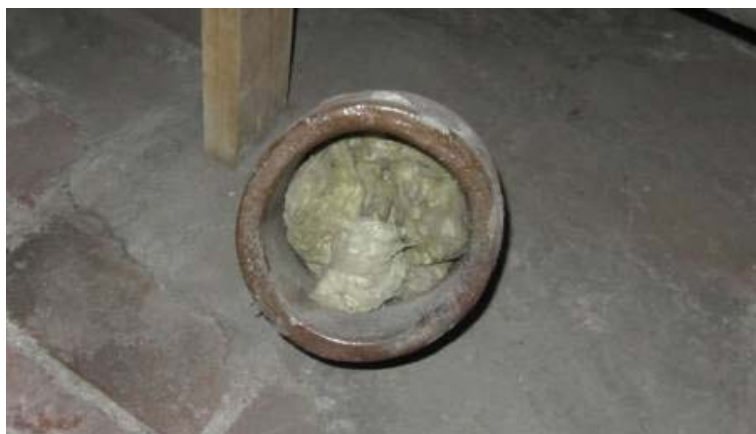
Kuva 23. Yläpohjan ullakotilassa on käytöstä poistettu tiivistämätön viemärin tuuletushormi.
