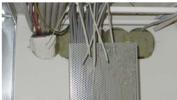
Kuva 27. Kolmannen kerroksen työhuoneen sähkötekniikan läpivientä ei ole tiivistetty välipohjan alapinnasta.
