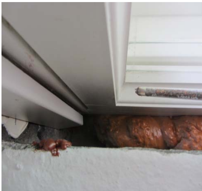
Kuva 37. Ulkoseinän ja ikkunan rakenneliitos on tiivistämätön.
