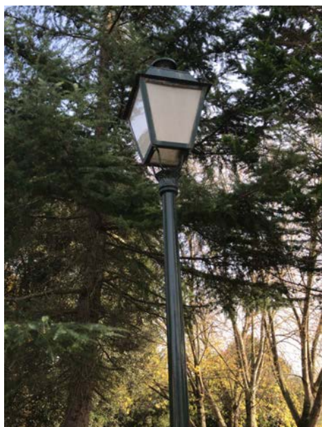
Imagen 5.17: Luminaria AP03. Fuente: Elaboración propia.
