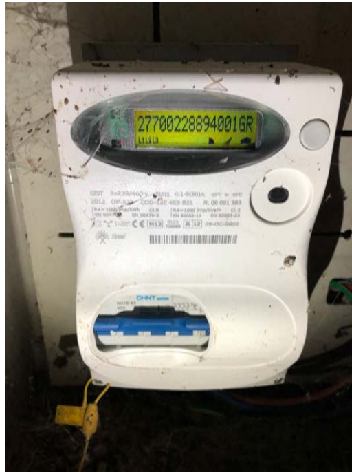
Imagen 5.14: Módulo de medida (contador – AP03). Fuente: Elaboración propia.
