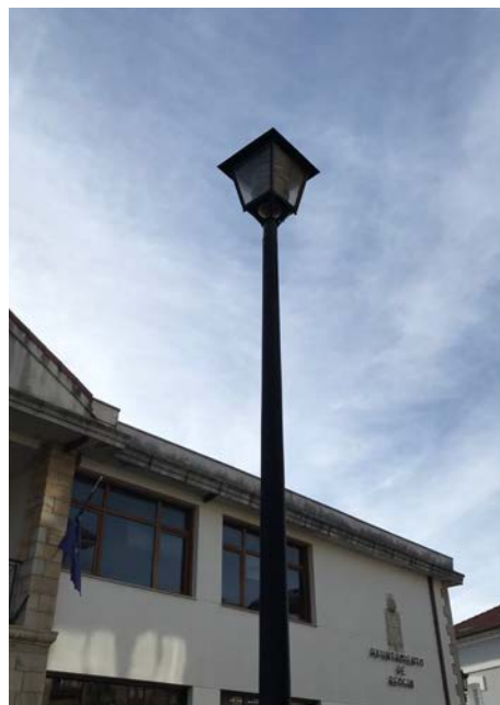
Imagen 5.12: Luminaria AP02. Fuente: Elaboración propia.
