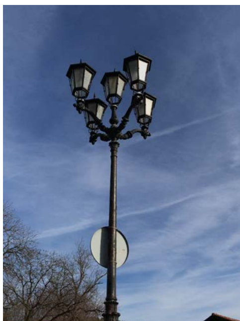
Imagen 5.13: Luminaria AP02. Fuente: Elaboración propia.
