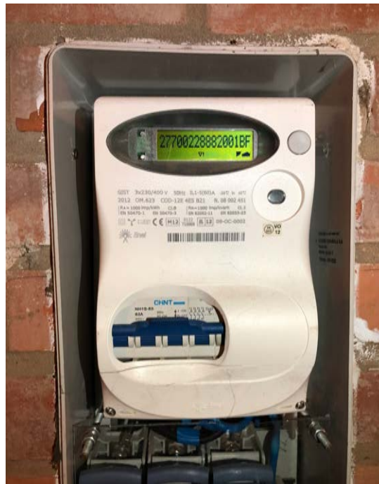
Imagen 5.10: Módulo de medida (contador – AP02). Fuente: Elaboración propia.
