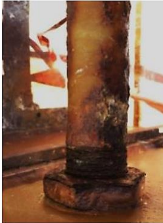
Figura 9 Corrosión por fatiga en elementos de acero sujetos a componentes de carga cíclica [42]
