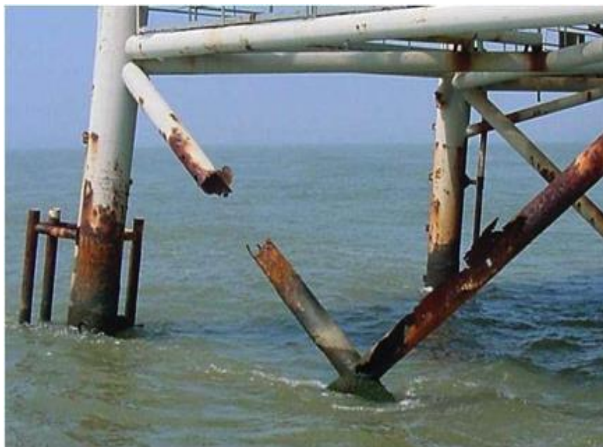
Figura 41 Corrosión en la zona de salpicaduras [100]
