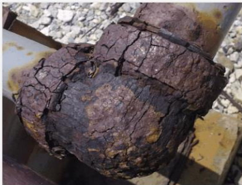
Figura 5 Corrosión por erosión en un codo de tubería [18]
