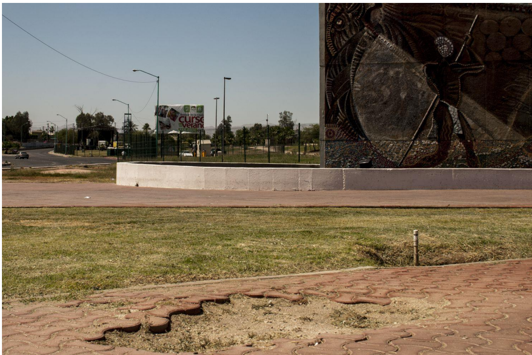
Imagen 8. Plaza Centenario en estado de deterioro. (Fuente: Peimbert, 2013)
