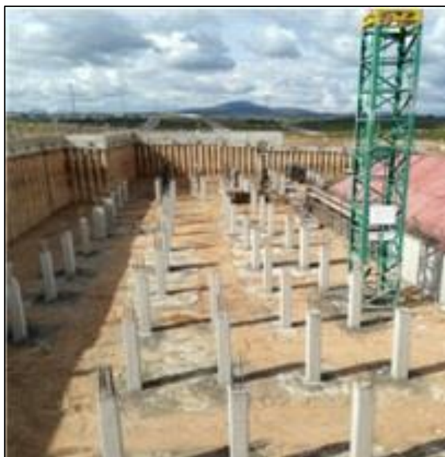
Fig. 8. Campo de captación bajo la losa del edificio {Las cuarenta y siete (47) perforaciones}.
