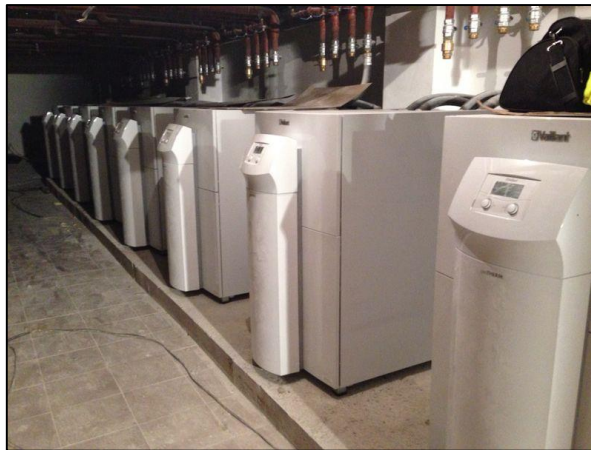
Fig. 7. Las ocho (8) bombas de calor geotérmicas del edificio.
