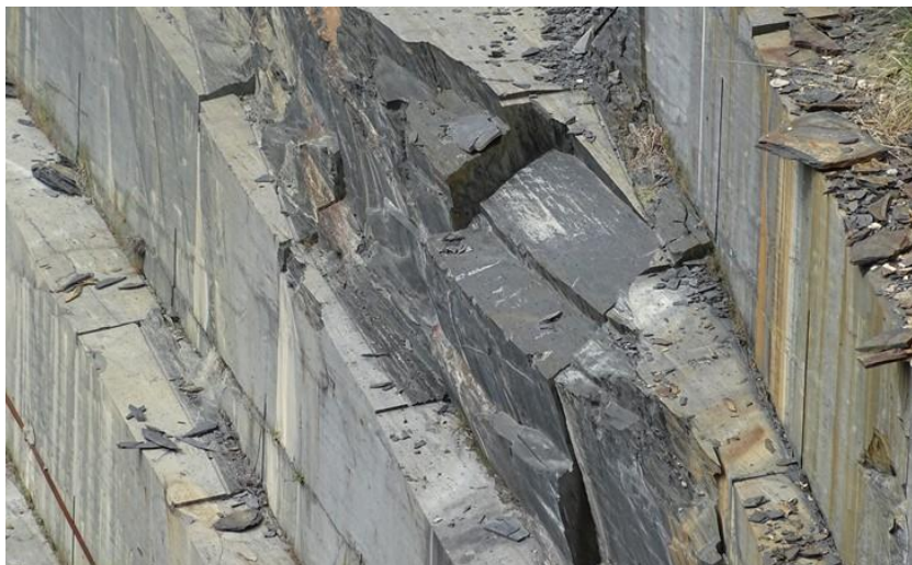
Figura 2.18 Fraturação por descolamento existente e subsidência na pedra da Milhária.
