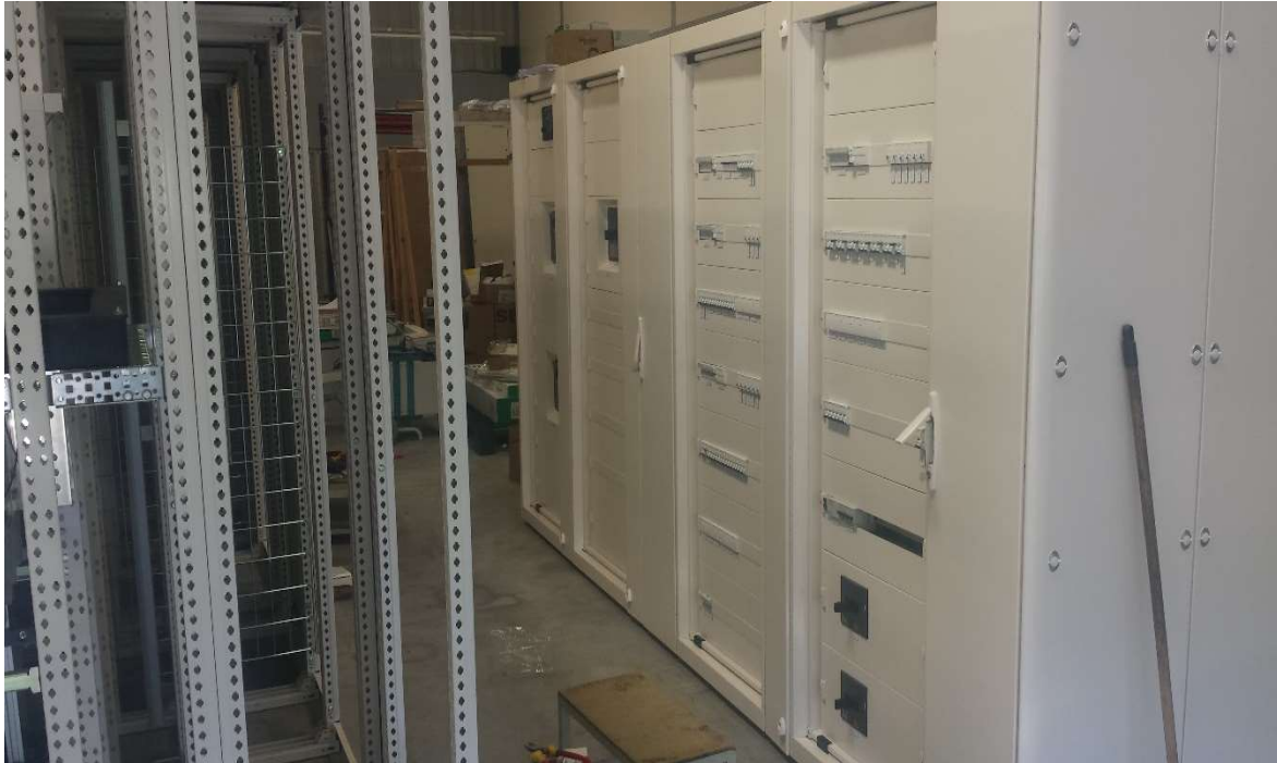
Figura 4 - Invólucro do quadro elétrico
