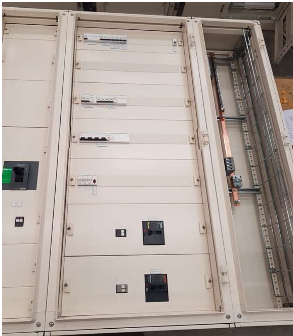
Figura 39 – Marcação e etiquetagem de um quadro elétrico
