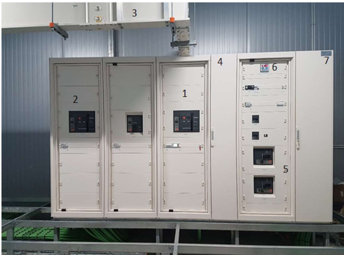
Figura 23 - Quadro de distribuição
