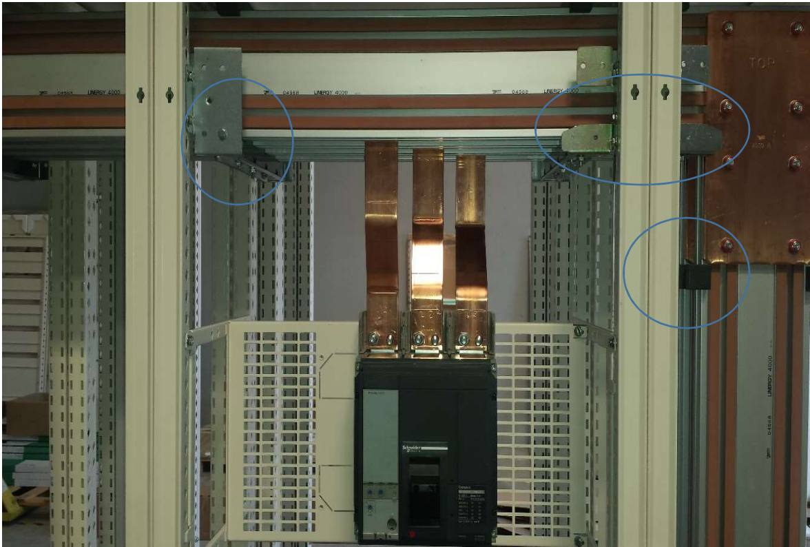
Figura 15 - Barramento fixo com isoladores Schneider
