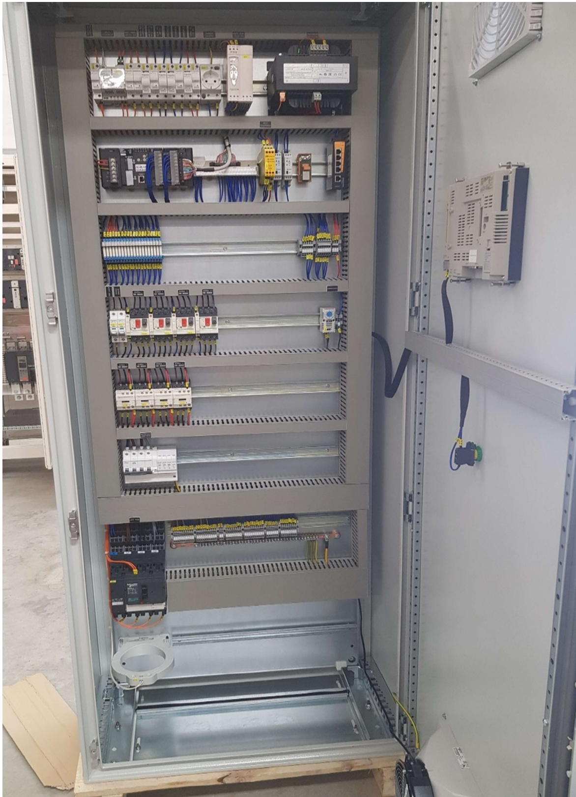
Figura 61 - Quadro devidamente eletrificado
