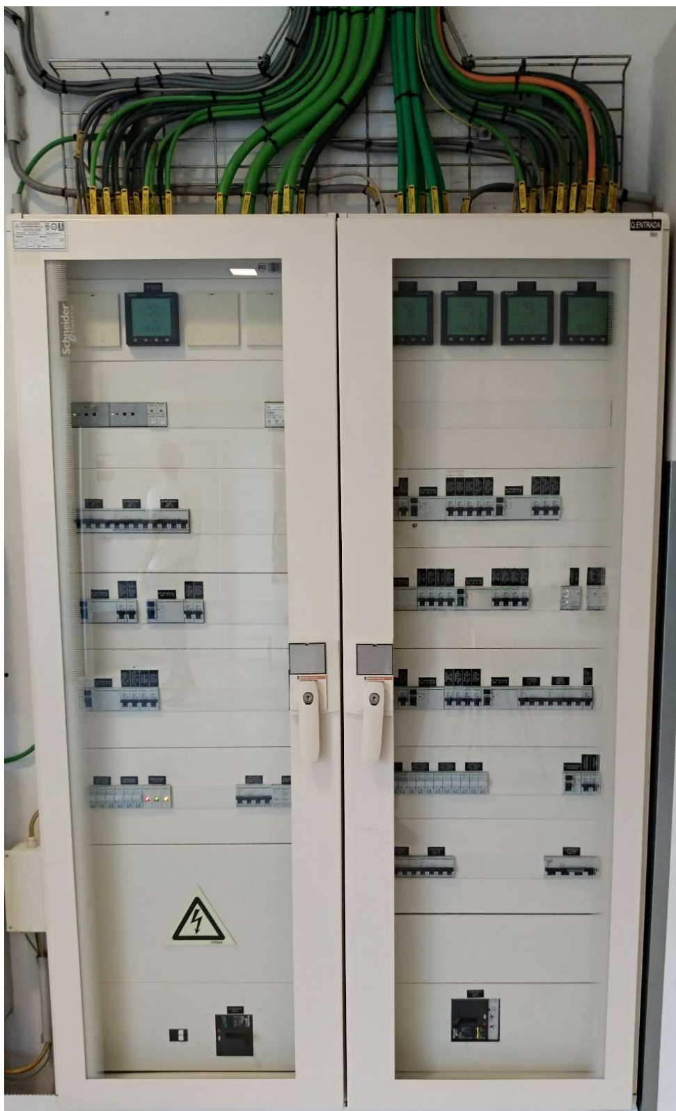
Figura 3 - Vista geral de um quadro elétrico de distribuição
