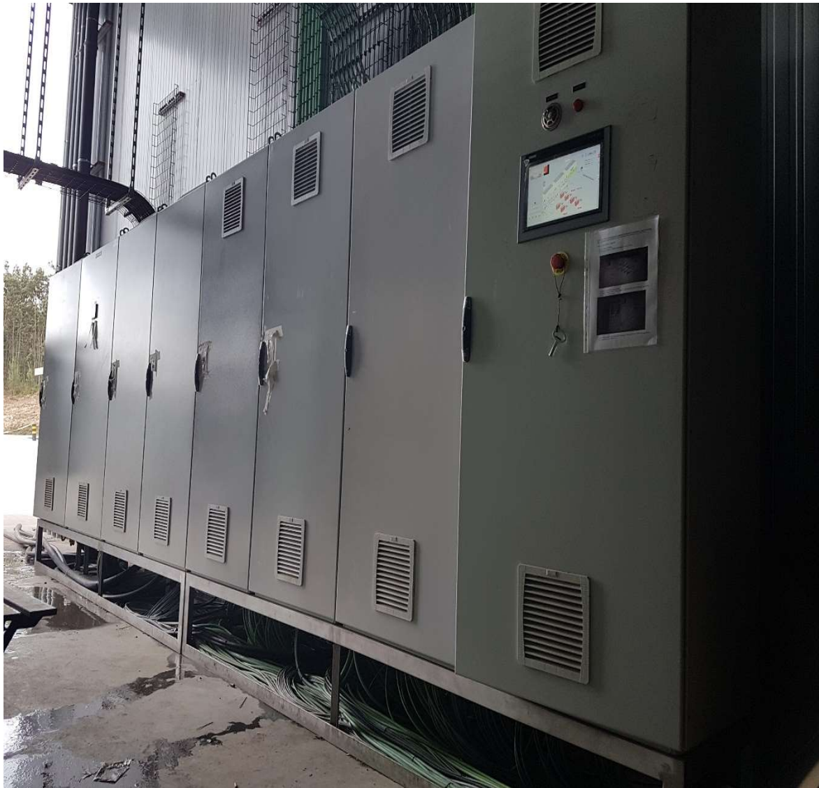
Figura 25 - Quadro de Comando (Controlo do frio de uma indústria alimentar)
