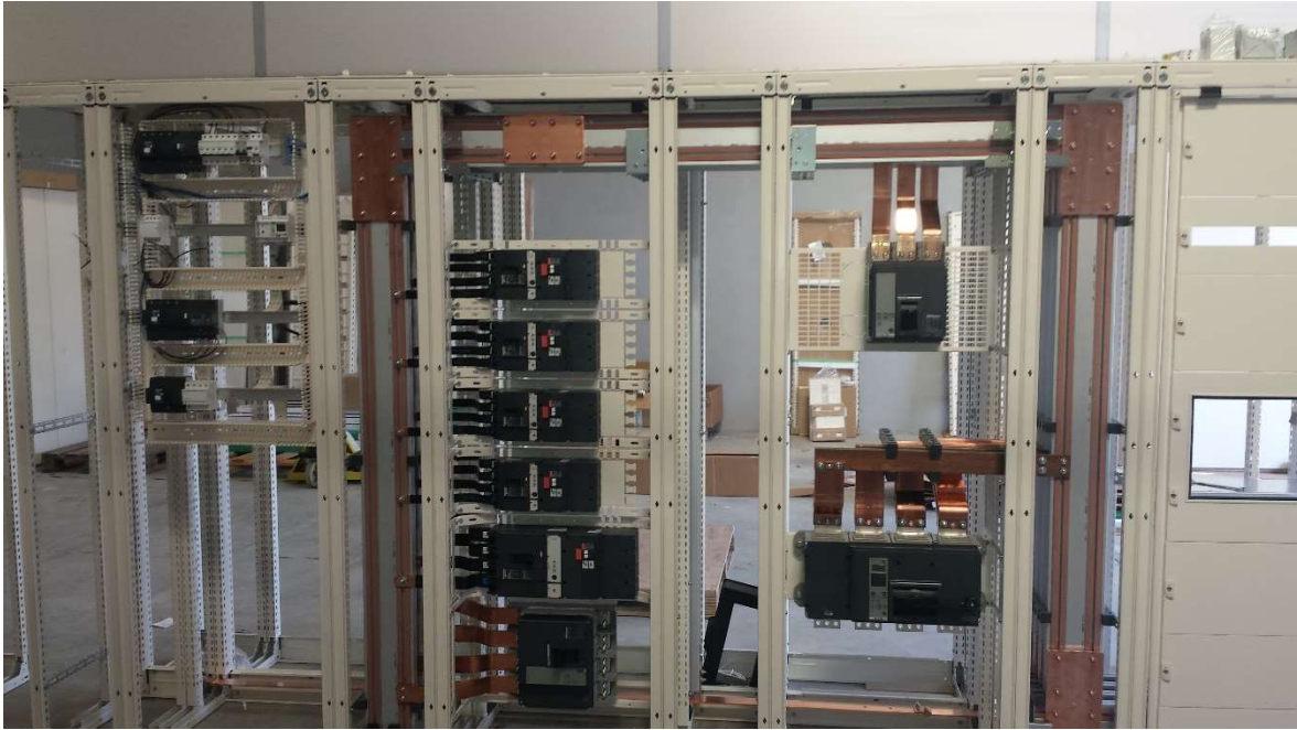
Figura 13 - Barramento principal, pré-fabricado
