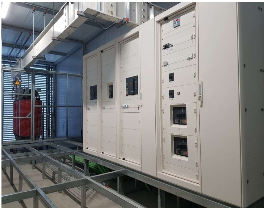
Figura 24 – Pormenor da canalização pré-fabricada de alimentação ao quadro
