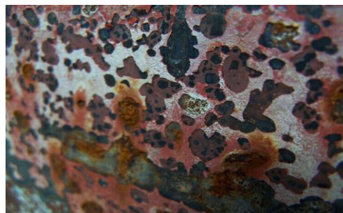
Figura 26. Superfície afectada per la corrosió. - Font: Zineti, S.A.U
