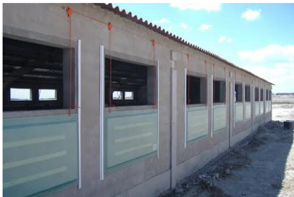
Figura 4. Finestres motoritzades tipus guillotina
