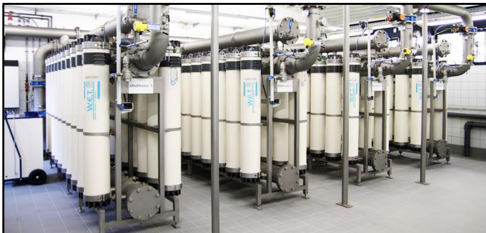
Il·lustració 49. Estació de membranes d'ultrafiltració
