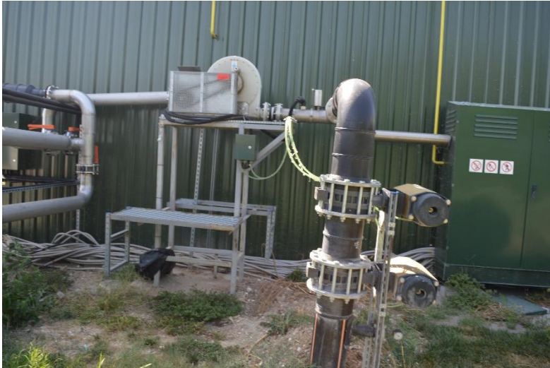
il·lustració 15 Compressor de refrigerant, corretja motor elèctric.
