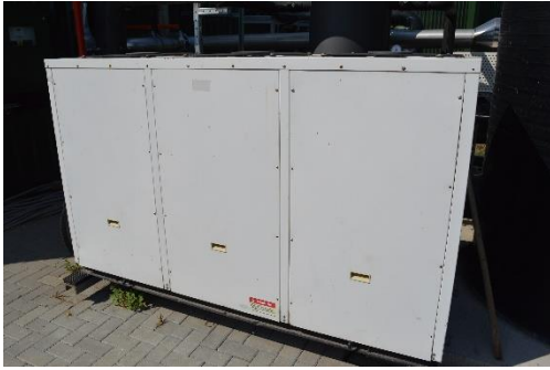
il·lustració 18 Caixers refrigerant, compressor.
