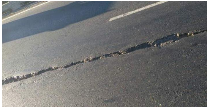
Fig. 2.25 Fractura en pavimento asfáltico (Fuente: Yutave Ingeniería, 2011).
