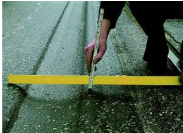
Fig.2.22 Formación de roderas provocada por la difusión insuficiente del rejuvenecedor (Mogawer et al., 2012).
