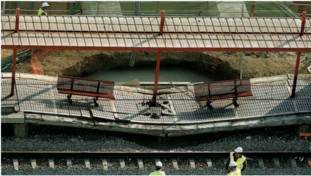
Figura 18: Esfondrament de l'andana de l'estació de Bellvitge causada per les obres de l'AVE. Font: La Vanguardia.
