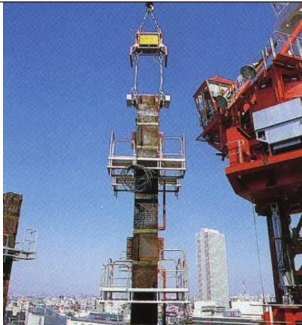
Imatge 4.24. En aquest cas, s'observa l'Auto-Clamp en acció, executant el posicionament d'una columna estructural d'acer. Font: Construction robots: elementary technologies and single-task construction robots.
