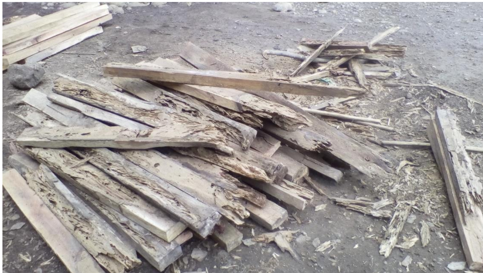
Figura 28. Reglas dañadas por termitas. Fuente: Julian Chun (2017).
