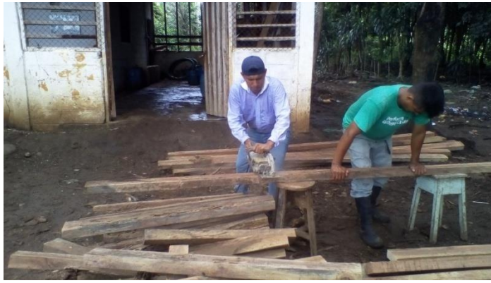
Figura 29. Corte de reglas dañadas por termitas. Fuente: Julian Chun (2017).
