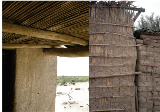
Figura 4. A la izquierda, cubierta construida con rollizo de álamo, caña como malla de repartición, torta de barro y lámina de polietileno. A la derecha, muro de quincha combinado con muro de adobe.
