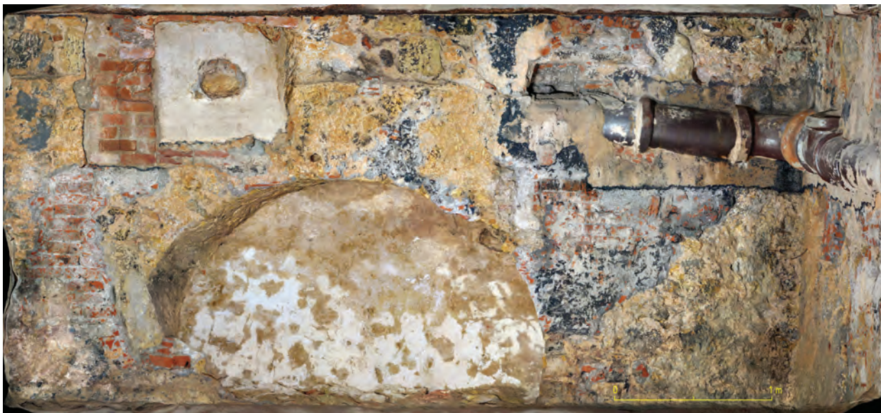
Fig. 7 Aspeto da parede Norte da cave do edifício na Rua da Prata, 45-51/ Rua de São Julião, 86-106 que em 1913 seccionou a “galeria das nascentes”, após a picagem dos rebocos recentes (imagem fotogramétrica - Arquivo CAL).
