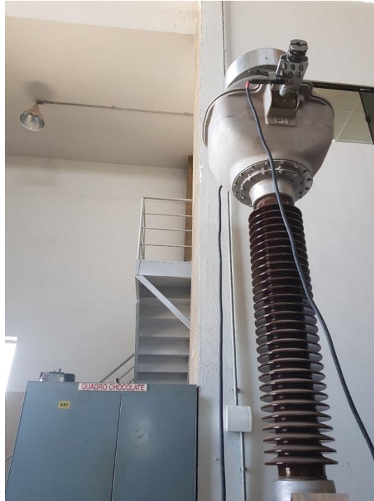
Figura 3.32 – Conexão do MIC 5005 com os terminais de alta do TC.
