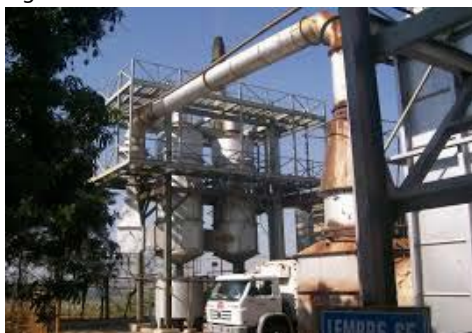
Figura – 5: Incinerador do SLU
