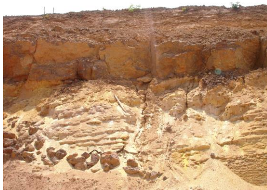
Figura 3. Vista geral de parte do Corte 16 com erosão superficial.
