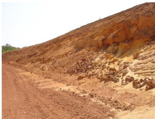
Figura 2. Vista geral de parte do Corte 16 com erosão superficial.
