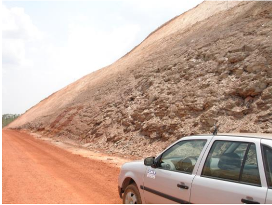
Figura 6. Talude do Corte 25 com início de processo de degradação do talude.
