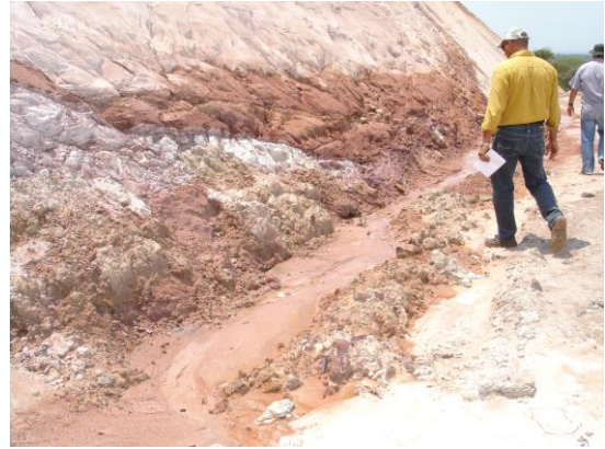
Figura 10. Saturação a partir da base do talude no Corte 25.
