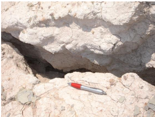
Figura 9. Trincas de tração em berma do Corte 25.
