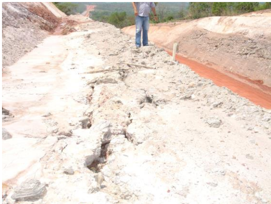
Figura 8. Trincas de tração em berma do Corte 25.
