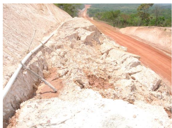
Figura 12. Trecho de ruptura no talude do Corte 25.
