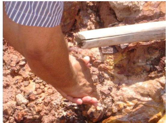
Figura 11. Mina d'água no talude do Corte 25.
