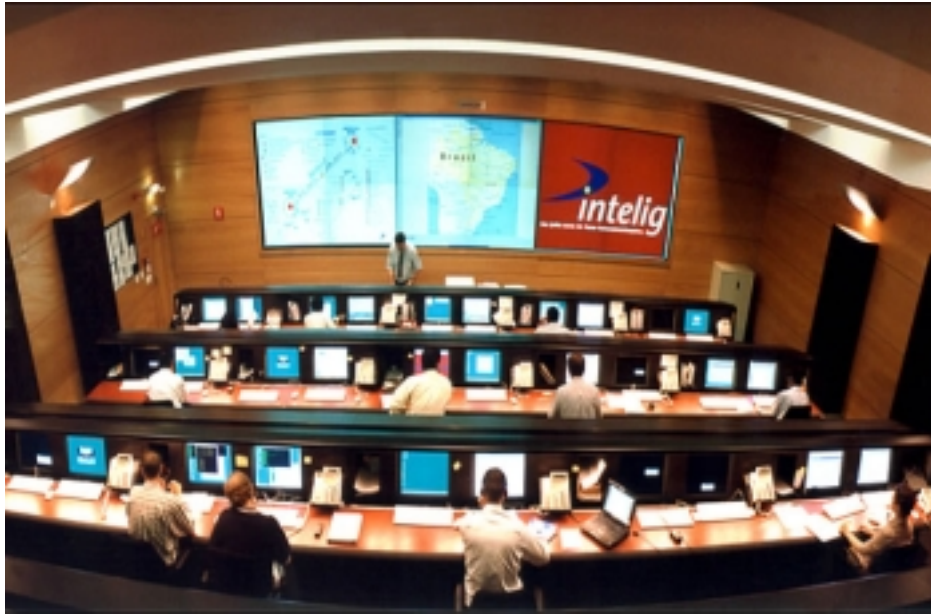
Figura 3: NOC da Osasco Telecom/Intelig
