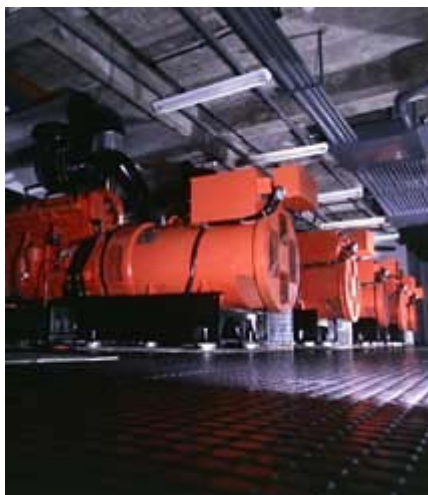
Figura 6: Grupo Gerador no DC da .comDomino em São Paulo
