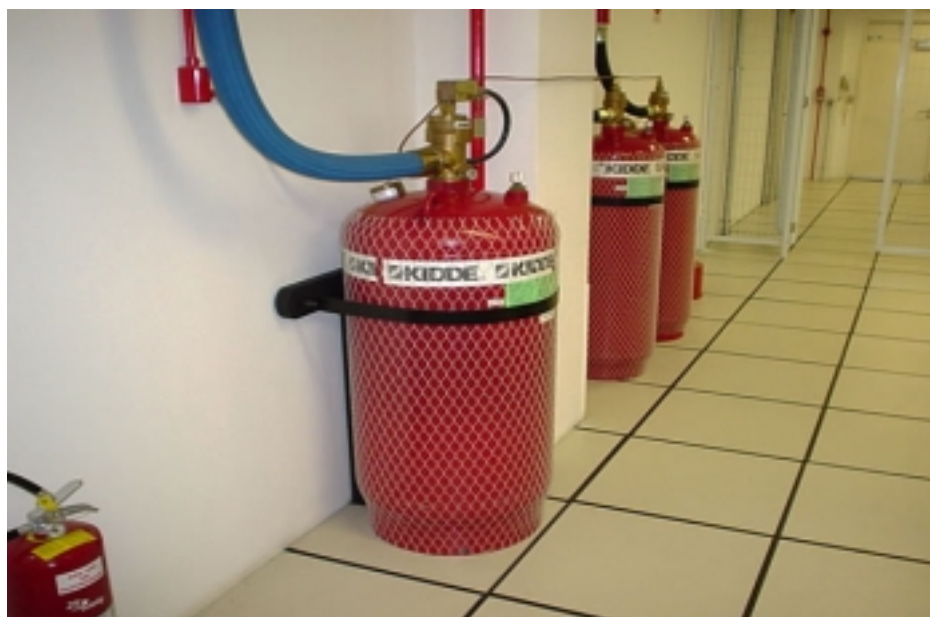
Figura 2: Cilindros de gás para contenção de incêndios.
