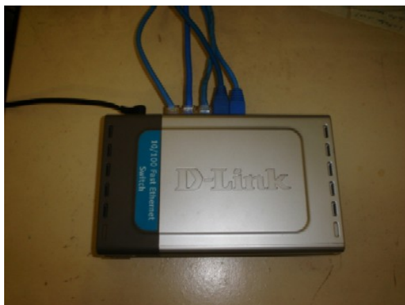
Figura 5-8 Switch de Rede montado
