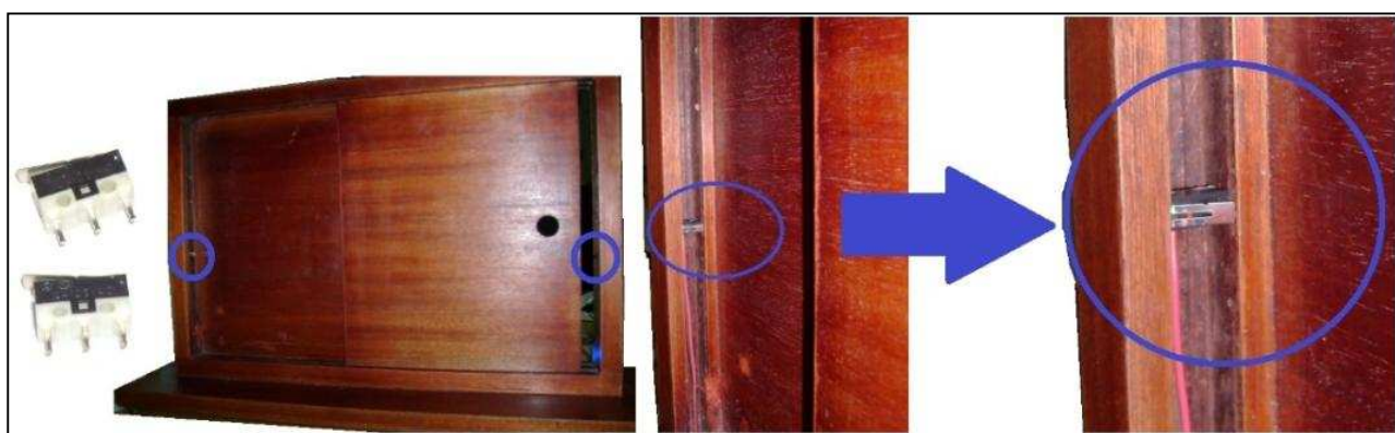
Figura 5.5 – Chaves microswitch fixadas nas canaletas.
