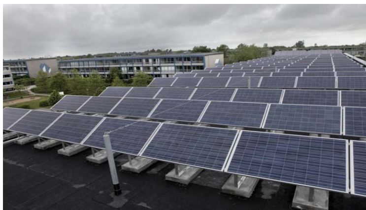
Foto 3: Solcellepaneler på Klimablokkens tag. I baggrunden fornemmes solfangere som bruges til opvarmning af brugsvand [Enemærke & Petersen]
