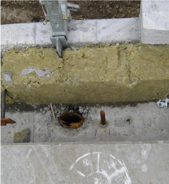
Billede 11: Sammenpresset korrugeret rør - i kælderelement [22.1.2008]
