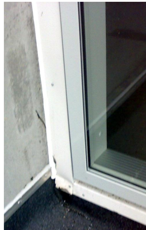
Billede 7: Fuge mellem Paroc-element og trappetårn [6. august 2008]
