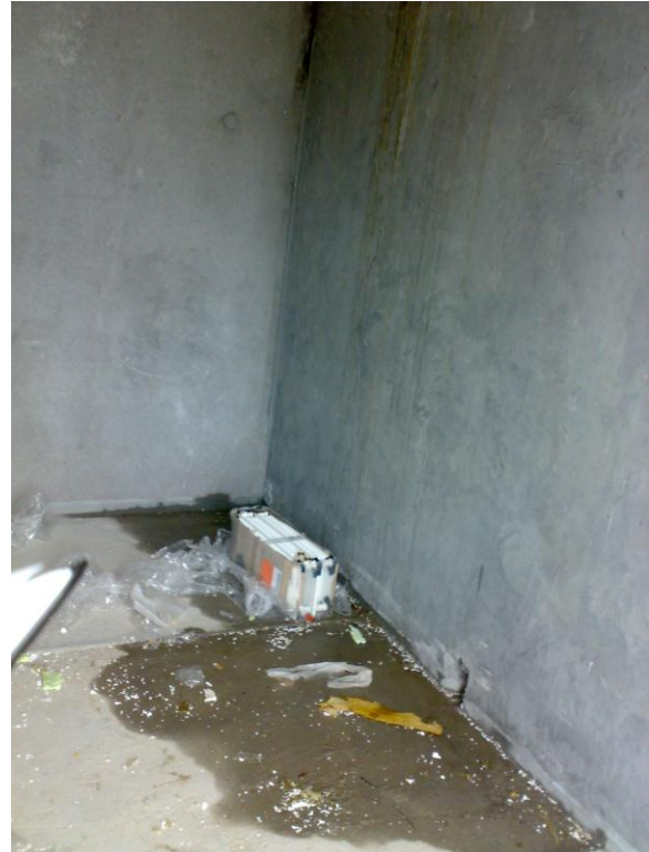
Billede 15: Vand på gulv i penthouse [6. august 2008].
