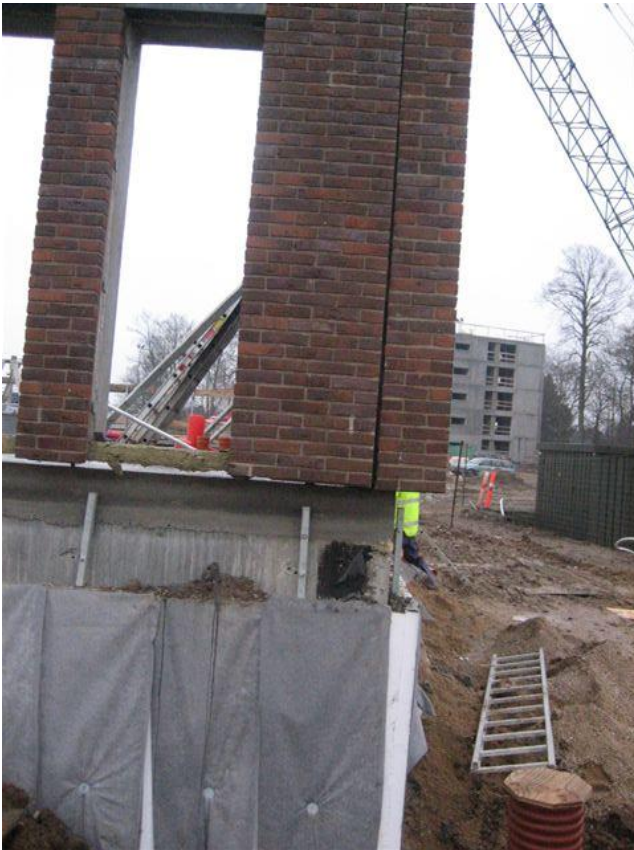
Billede 21: Formandens billede af elementerne med for meget isolering [14.1.2008].
