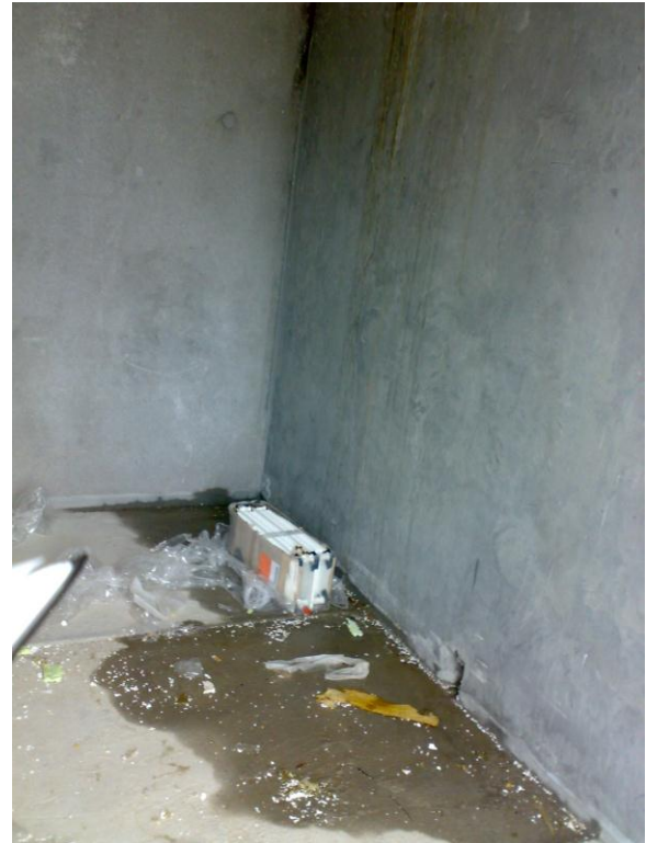
Billede 6: Vand på gulv i penthouse [6. august 2008].
