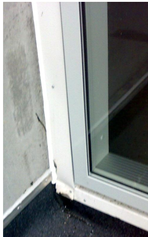
Billede 16: Fuge mellem Paroc-element og trappetårn [6. august 2008].
