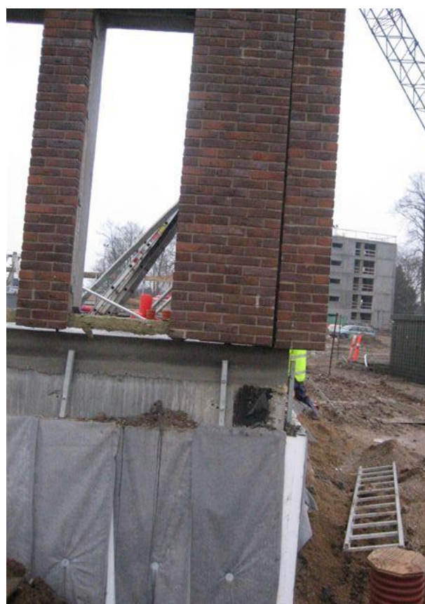
Billede 2: Formandens billede af elementerne med for meget isolering [14.1.2008].
