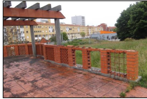
Foto 7 – Falta de varanda em alguns pontos do miradouro.
