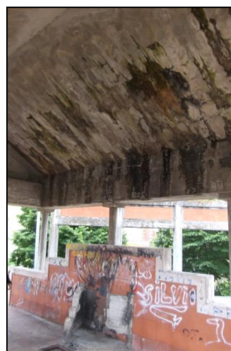
Foto 6- Tetos das zonas cobertas degradados provocados pela humidade.
