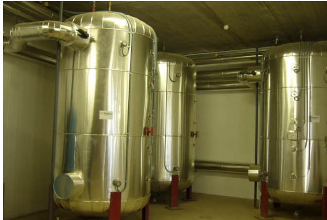
Figura 22. Acumuladors d'aigua calenta. Font: Elaboració pròpia
