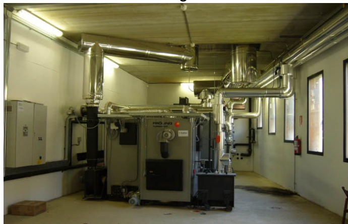
Figura 21. Dues calderes de biomassa connectades. Depòsit de cendres. Font: Elaboració pròpia.
