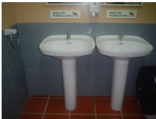
Imatge 7-3: Aixetes instal·lades en els lavabos de noies
