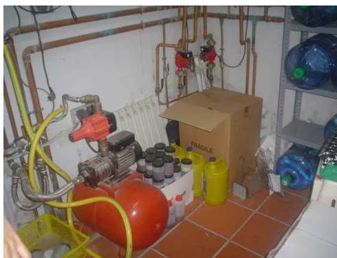
Imatge 7-11: Bomba de circulació Font: Elaboració pròpia
