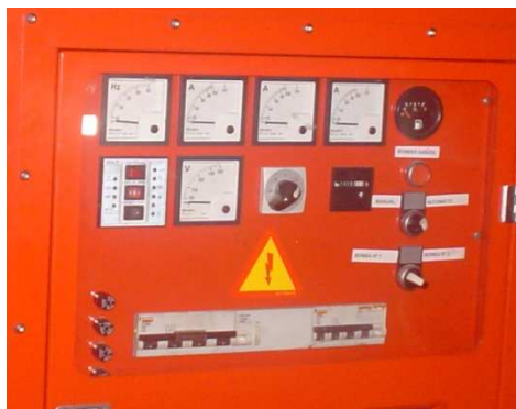
Imatge 7-8: Comptador d'hores del generador Font: Elaboració pròpia
