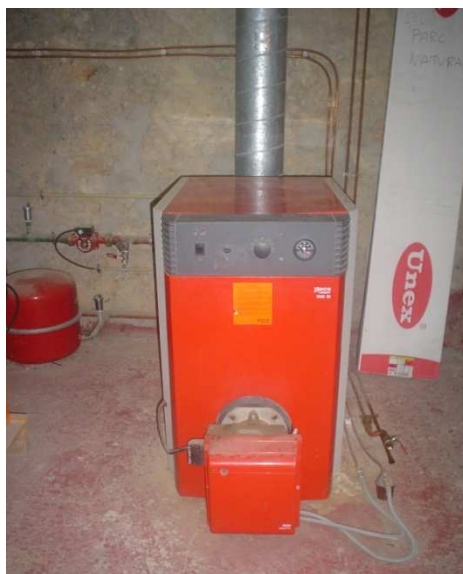
Imatge 7-9: Caldera Font: Elaboració pròpia
