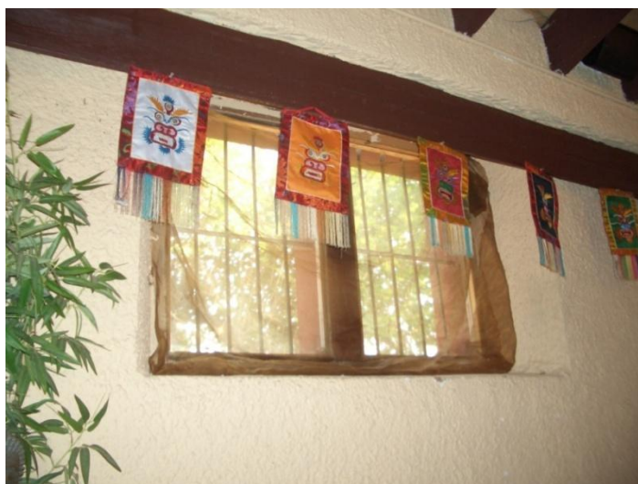
Figura 5. 9: Imagen de una ventana del Restaurante sin cristal. Fuente: Elaboración propia (2009).
