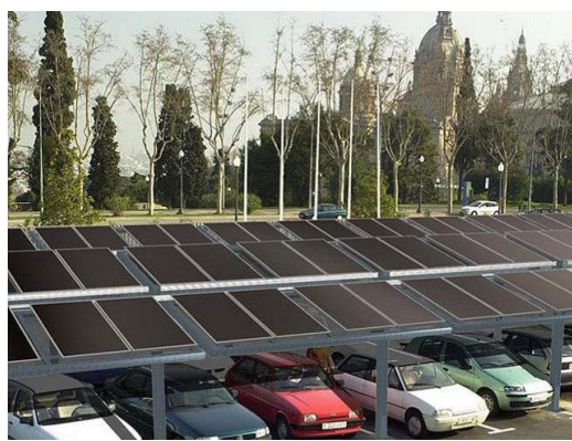
Figura 1. 20: Imagen de las placas solares térmicas del aparcamiento. Fuente: Solarge ( www.solarge.org )
