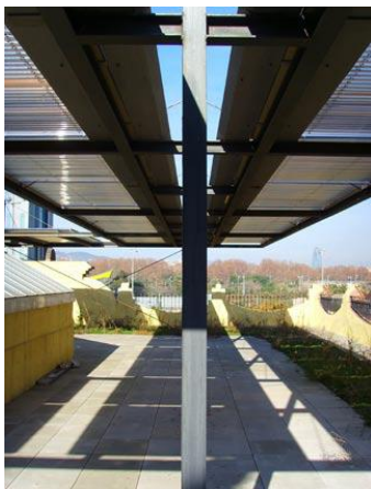
Figura 1. 18: Imagen de los colectores solares en la azotea del edificio. Fuente: La Fábrica del Sol.
