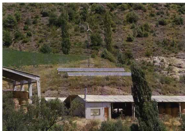
Figura 1. 23: Imagen de la instalación eólico-fotovoltaica. Fuente: ICAEN
