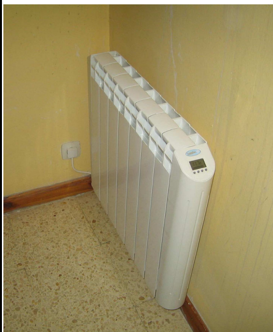
Detall del sistema de calefacció elèctrica.
