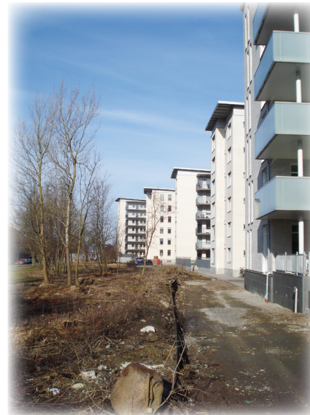
Figur 60. Järnvägsspår återfinns vid byggnationen.
