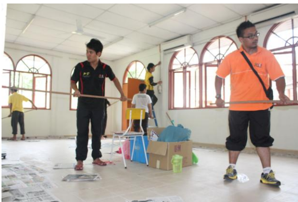
Mengecat pusat sumber
