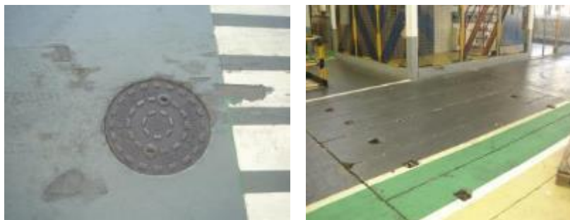
Figura 40 - Exemplo de situações a ser corrigidas no chão da fábrica.
