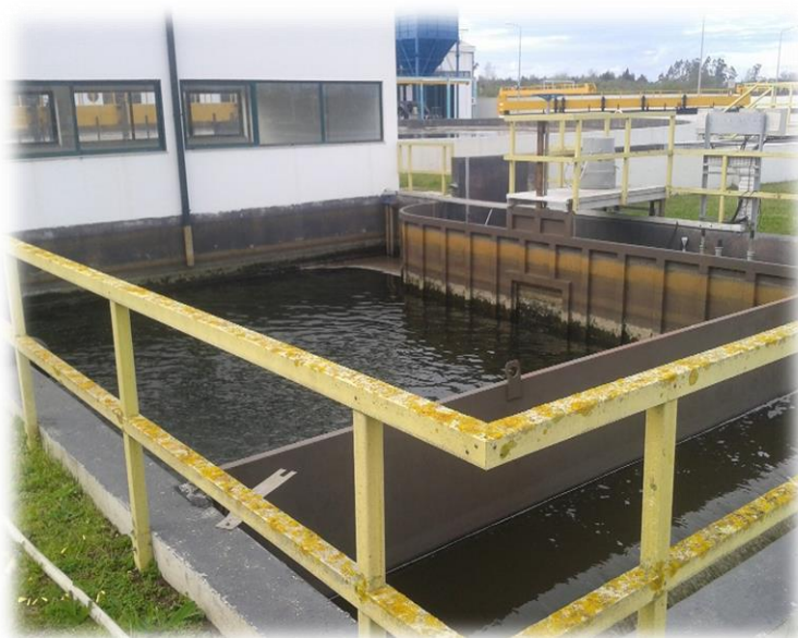
Figura 9-Reservatório da Água Tratada
