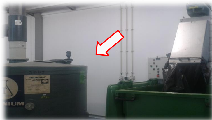
Figura 36-Torre de carvão ativado
