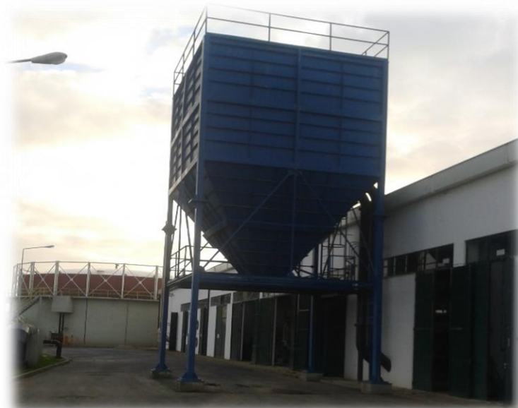
Figura 15-Silo para armazenamento das lamas desidratadas e estabilizadas
