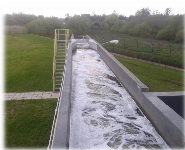
Figura 5-Medidor de Caudal, do tipo Parshall
