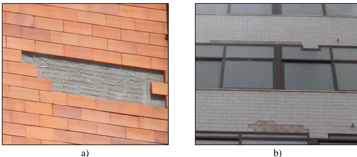
Figura 6: Destacamento de cerâmicos: a) Zona corrente; b) Zona de extremidade (CHAVES, 2009).
