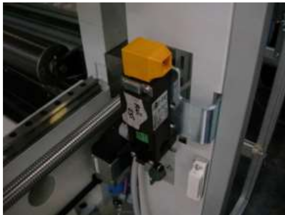
Foto 29. Elettroserratura posizionata in macchina.
