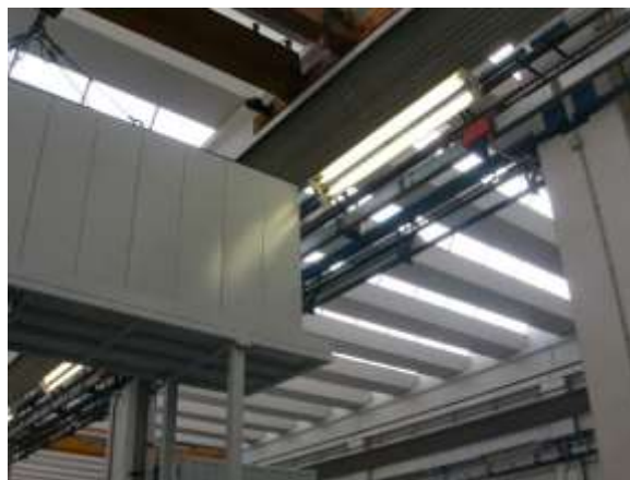
Foto 39. Interferenza quadro elettrico con lampada a soffitto del capannone.
