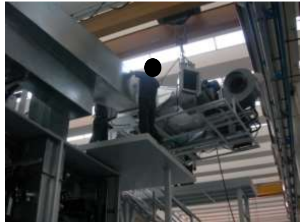
Foto 60. Difficoltà di montaggio gruppo di ventilazione sopra ponte per impedimenti in altezza.
