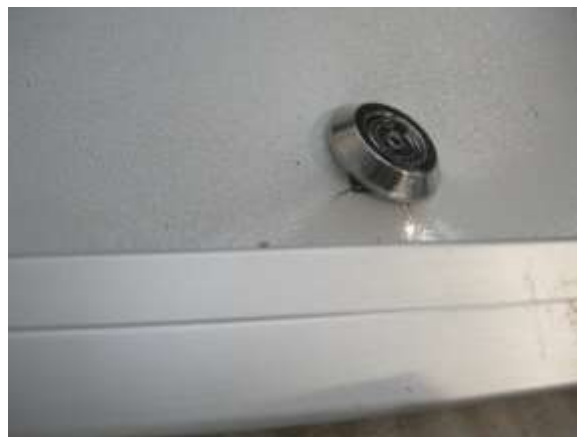
Foto 64. Serratura porta rovinata nel suo imballaggio dal peso delle carenature superiori.
