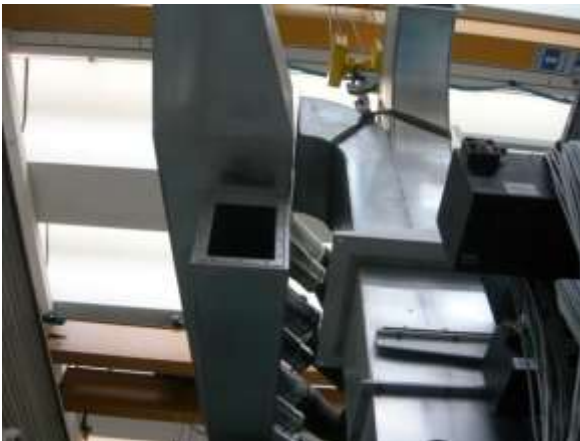
Foto 28. Gioco presente tra condotto d'essiccazione ponte e condotto d'essiccazione principale.
