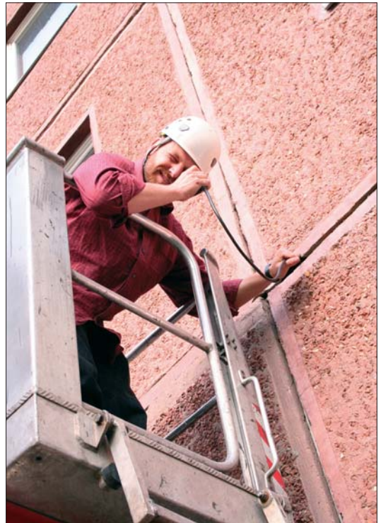
Abb. 1 und 2: Endoskopische Untersuchung der Fassade auf der Ostseite der Willi-Bredel-Straße 14-19 in Halle/Saale mittels Hubsteiger am 06.07.2005. Fotos: K. Müller.
