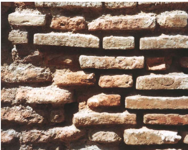
Figura 1.1. Ejemplo de deterioro de ladrillos por cristalización de sales (Rauda Real de la Alambra, Granada).
