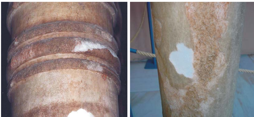
Figura 2.4. Detalle de localización principal de descamación en zona de anillos y fuste de columnas.
