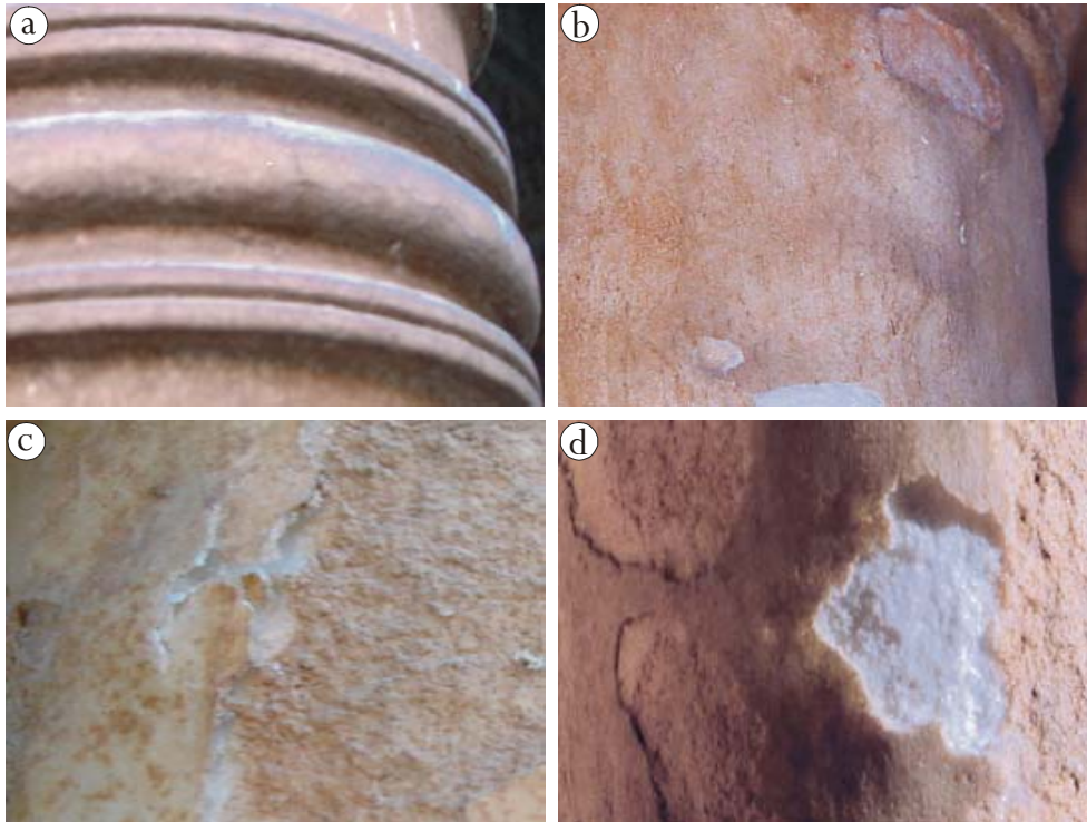
Figura 2.3. Desarrollo del proceso de descamación producido en las columnas a) microfisuración; b) abultamiento-hinchazón; c) pérdida de cohesión y d) desprendimiento.
