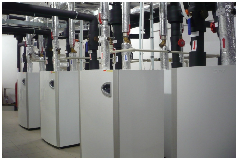
Obr. 11 Tepelná čerpadla 10 ks
