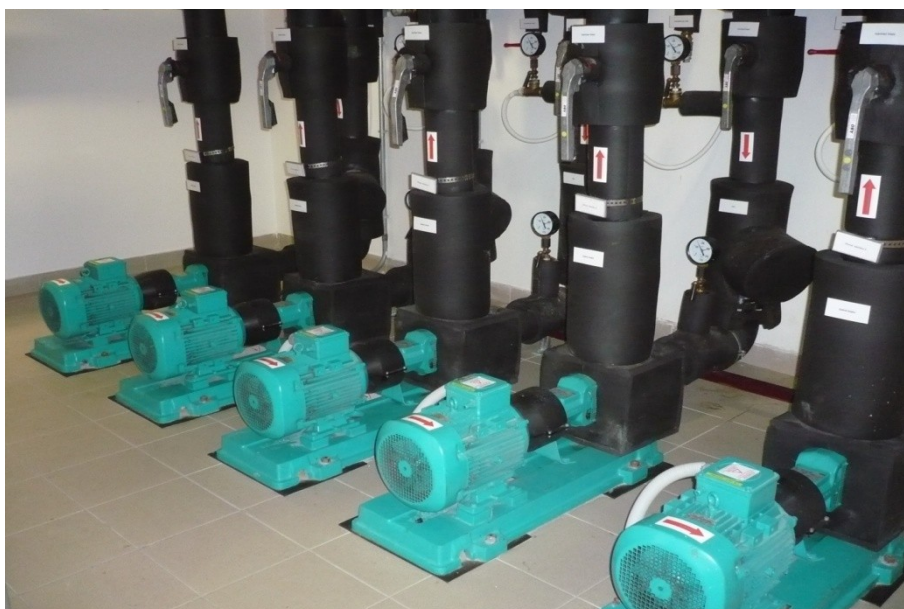
Obr. 17 Oběhová čerpadla primárního okruhu 5 ks
