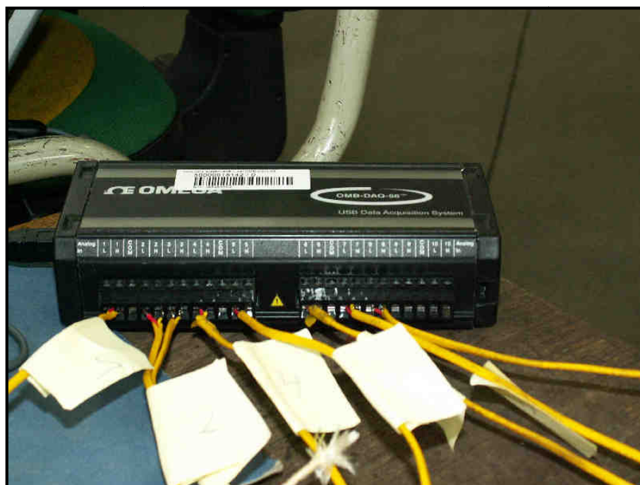
Obr. 10: Měřicí stanice s připojeným kompenzačním vedením
