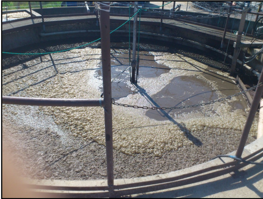
Obrázek 12: Celkový pohled na biologickou linku 1, podél aktivace se nachází nádrže pro kalové hospodářství (Maráková, 2013)
