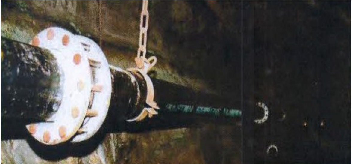
Obr. č. 11 Důlní plynovod sestavený z polyesterových trubek
